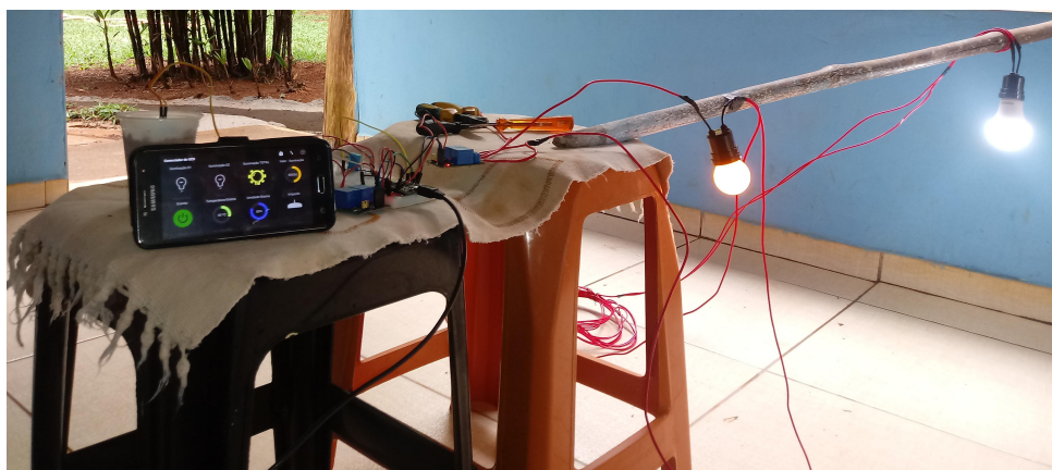
Figura 4.13: Módulos de Controle de Iluminação e Irrigação - (Parte 3)
